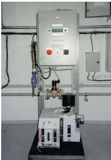
Стационарный вакуумный насос
