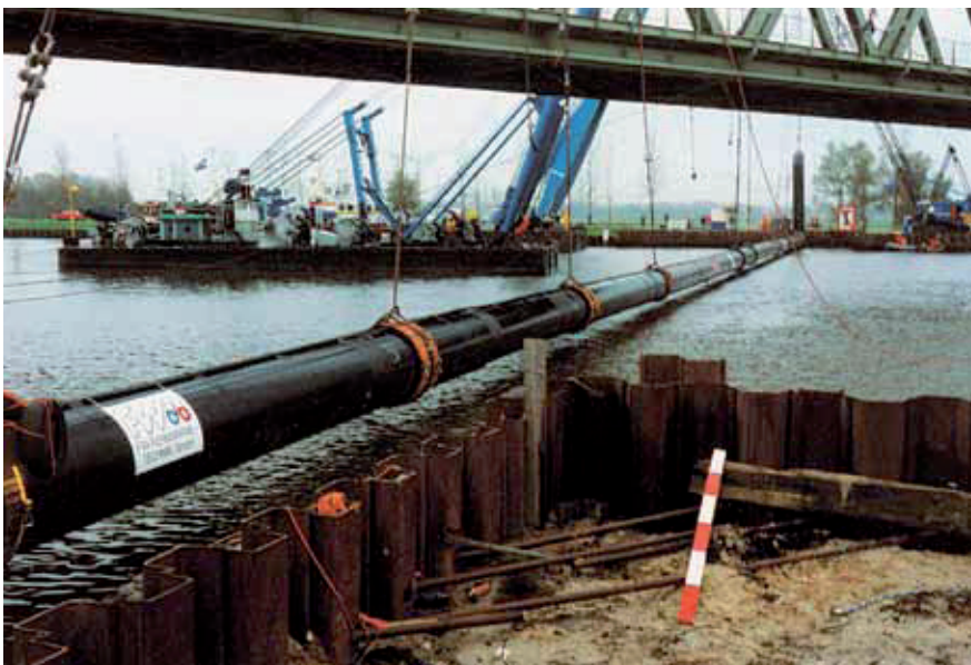
Bild 1. Leitungen kreuzen die Großwasserstraße Amsterdam Rijnkanaal
