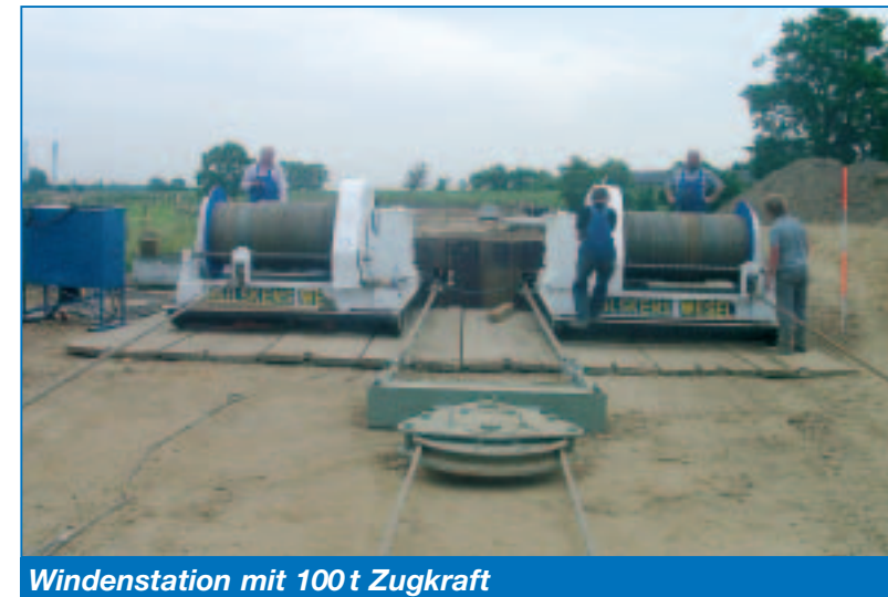
Windstation mit 100t Zugkraft
